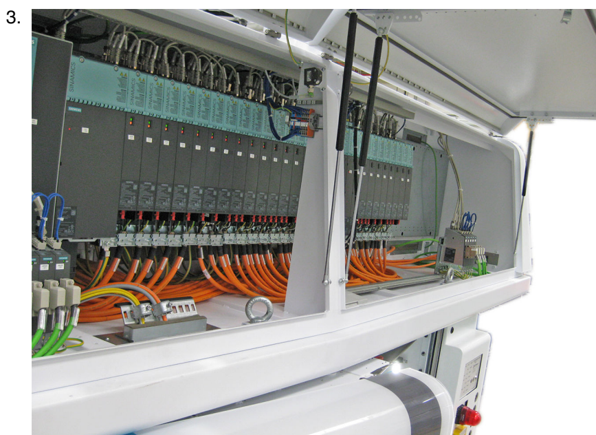
Beispiel: Schaltschranktüren an einer Mehrspindel- Drehmaschine
